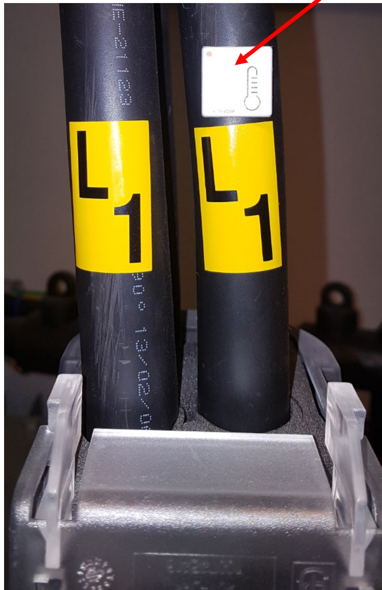
Temp måling på trafo/kabel
