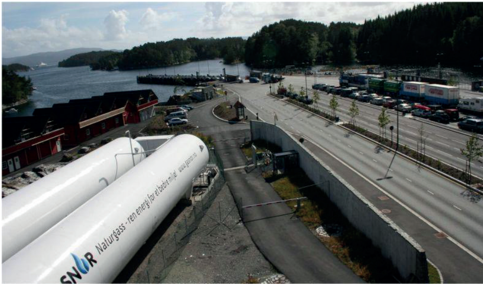
Figure 42: LNG-storage at Halhjem
